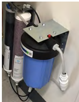
House DI water system
